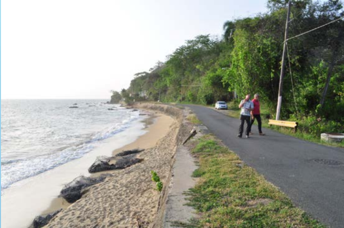
Barrero (Rincon), PR – Danos y vulnerabilidad en carreteras- 2015
